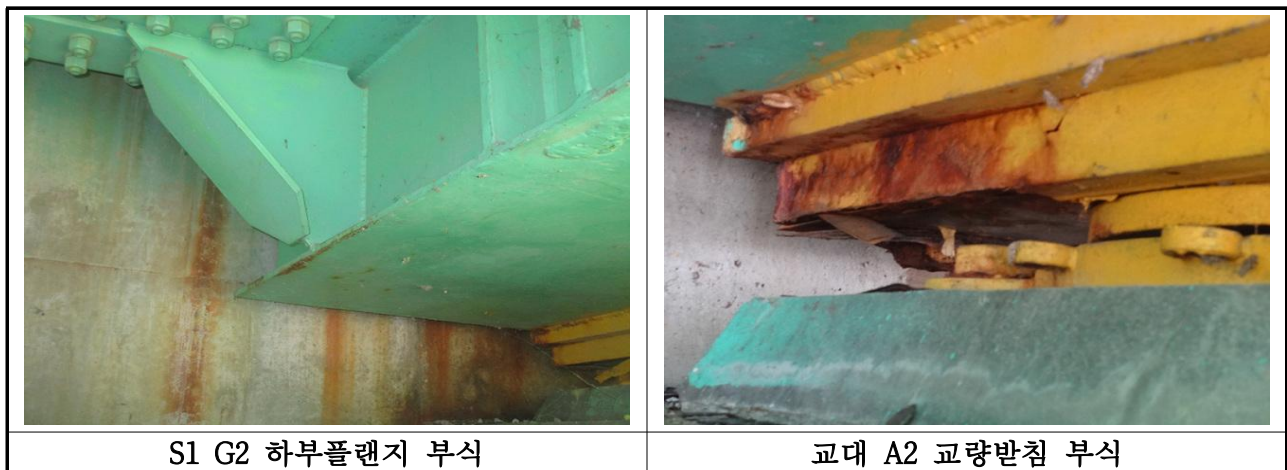
【사진 7.1】 신축이음 누수에 따른 손상 발생 현황
